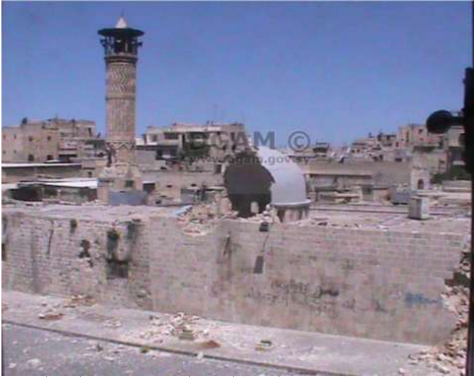
لوحة رقم (٩) الدمار الذي لحق بالقبة والمنذنة وواجهة الجامع، عن المديرية العامة للأثار والمتاحف، ٢٠١٦/١٠/٢٥.
