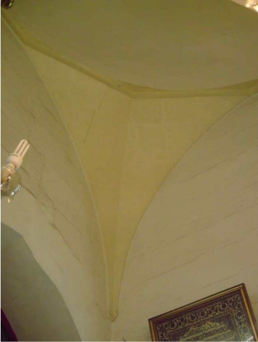
لوحة رقم (١) المثلثات الهرمية في منطقة الانتقال من الشكل المربع إلى الشكل الدائري، تصوير الباحث
